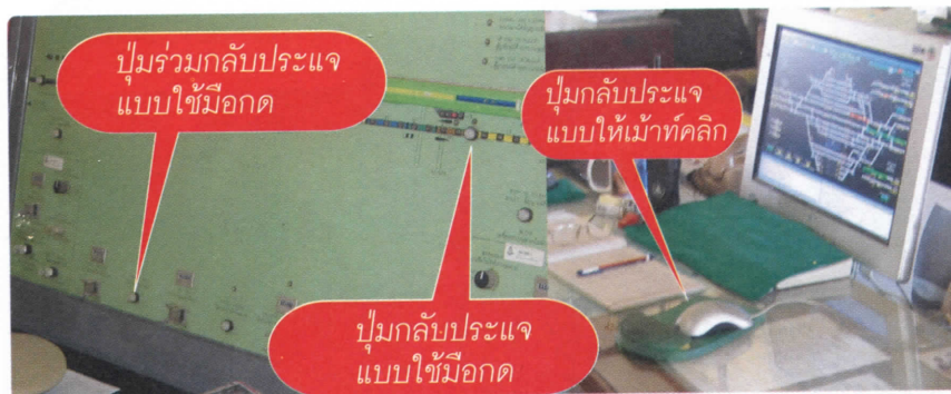
รูปแสดงอุปกรณ์กลับประแจชนิดควบคุมด้วยคอมพิวเตอร์
