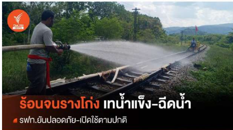
รูปภาพที่ 13 : รางรถไฟโค้งตัวจากสภาพอากาศร้อนจัดในฤดูร้อน
